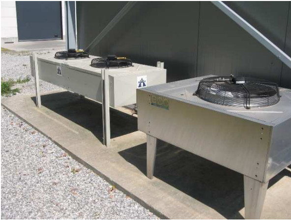
photo : « condenseurs SUD_9446.jpg »
