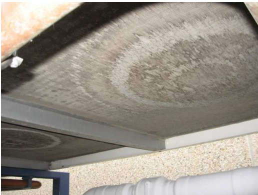
photo « condenseur bouché_9269.jpg »
